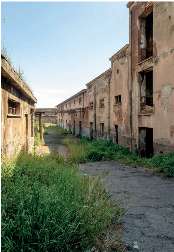
fig. 83 Sopralluogo: vista dall'ingresso secondario. Vegetazione incontrollata
