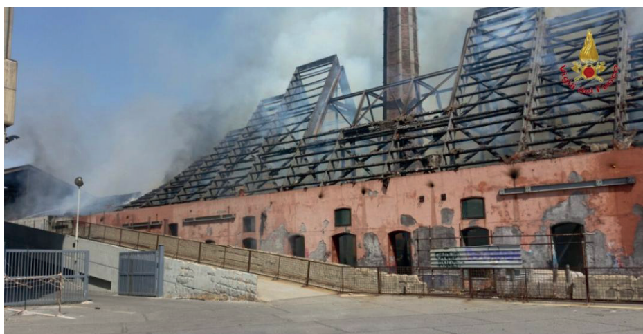
fig. 71 A seguire dello spegnimento dell'incendio. La copertura è andata perduta
