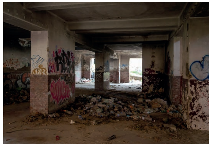
fig. 84 Sopralluogo: spazzatura accumulata dai senzatetto che abitano la struttura
