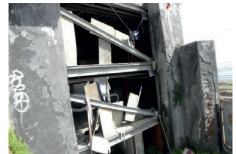
fig. 69 Chiusure improvvisate dai senzateo
