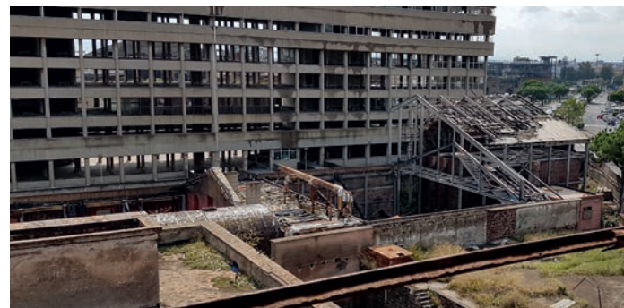
fig. 75 Sopralluogo: sulla destra si può vedere la struttura in decadenza
